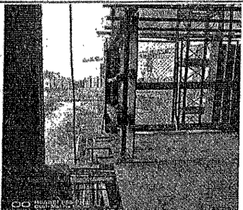
个别人货梯旁防护设置拆除未恢复整改前
