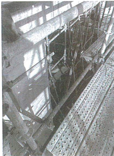
盘扣脚手架内隔离未设置到位
