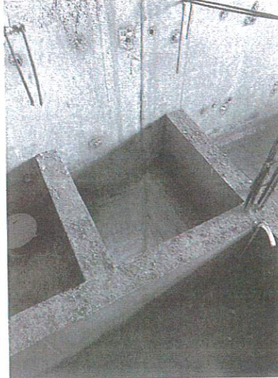
洞口未设置安全防护措施
