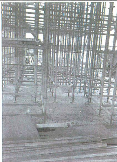
扫地杆拆除后未恢复安装
