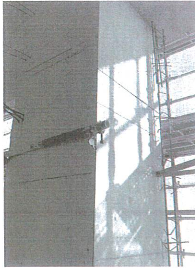
框架柱抱箍拉墙杆不到位
