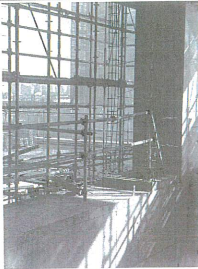
安全防护栏杆立杆倾斜
