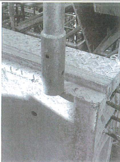
排架立杆悬空
