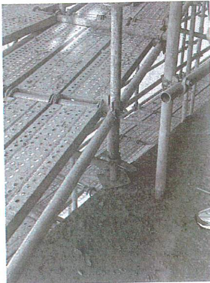
立杆未立在楼板
