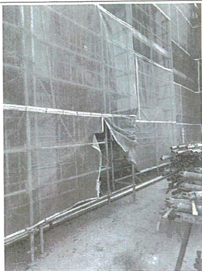
未搭设安全防护隔离棚
