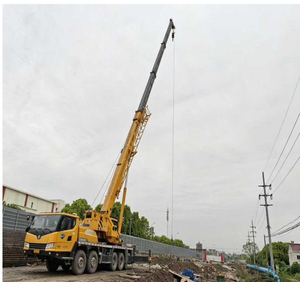
图 1 吊车及高压线
