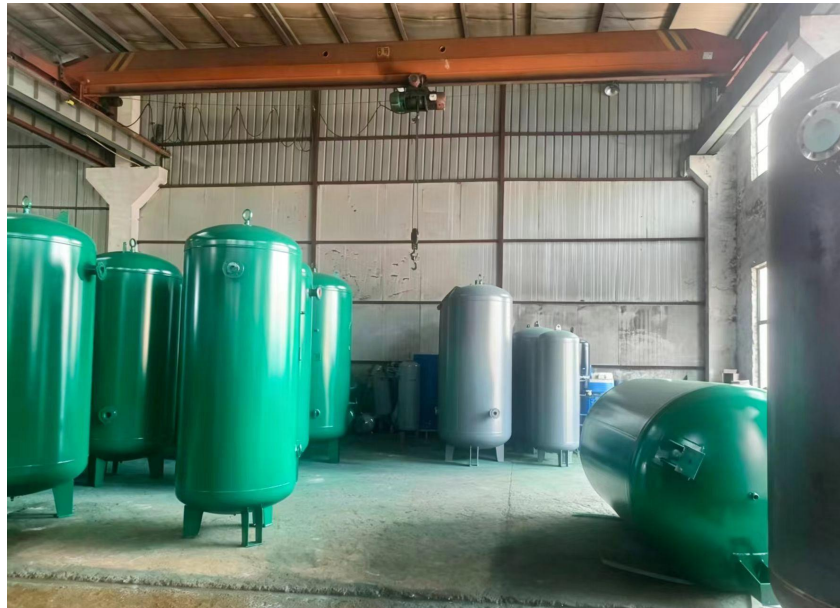
图 1 涉事压力容器罐
